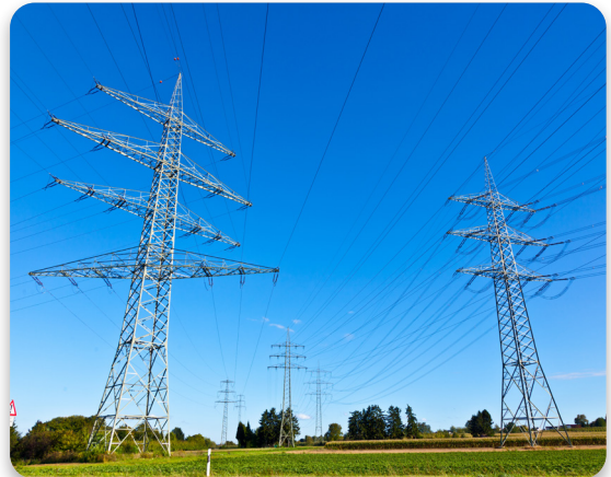
Görsel 6.4. Elektrik İletimi
