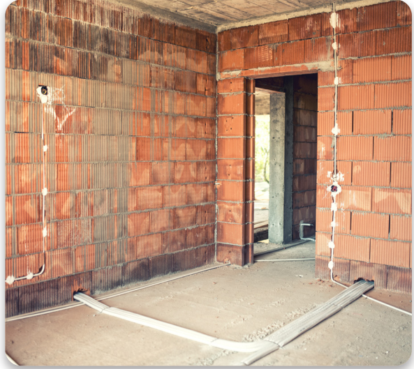
Görsel 7.4. İnşaatlardaki Elektrik Kabloları
